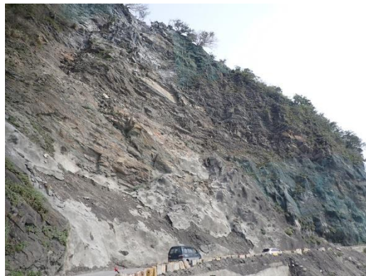
圖版 26、9 號省道 149.8K 崩塌面。
