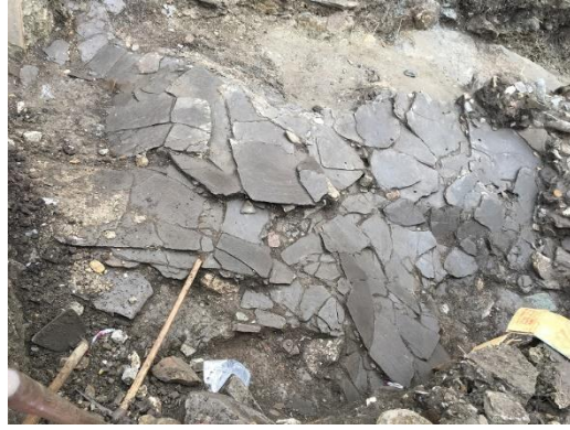
圖版 30、漢本遺址殘破的板岩地板。
